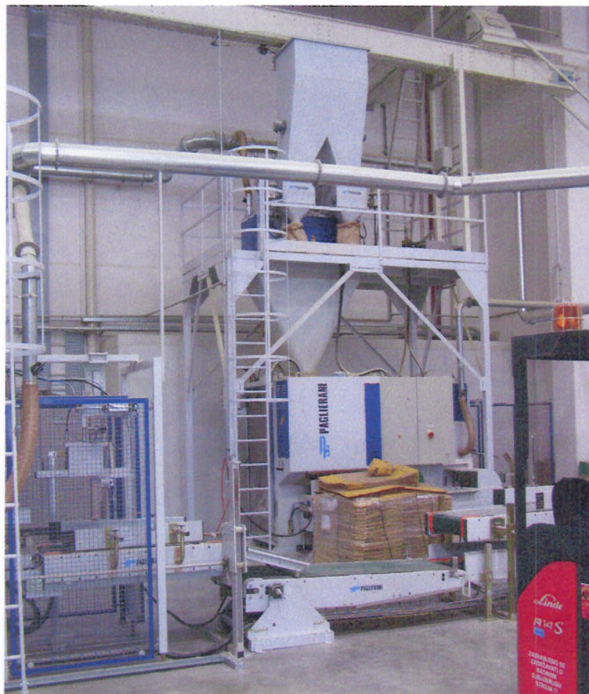
Na slici se vide dvije vage Paglierani NE-N montirane iznad uređaja za uvrećavanje.
